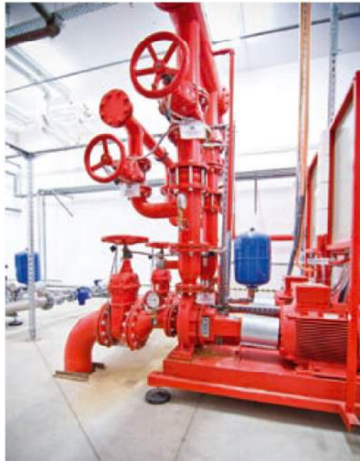
1. Zestaw pompowy instalacji tryskaczowej zamontowany w galerii handlowej
