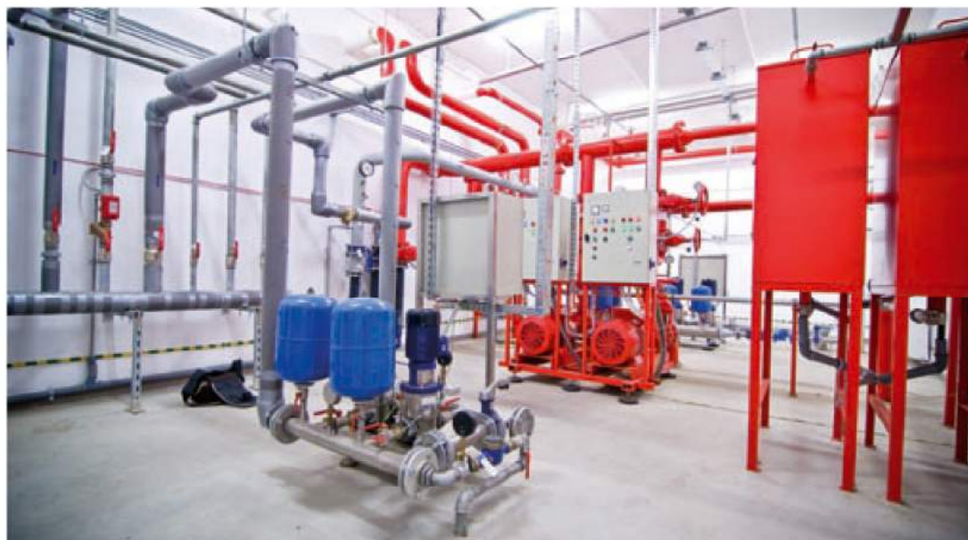
3. Na pierwszym planie: zestaw pompowy instalacji hydrantowej, w tle – zestaw pompowy instalacji tryskaczowej. Oba zestawy pracują niezależnie od siebie
